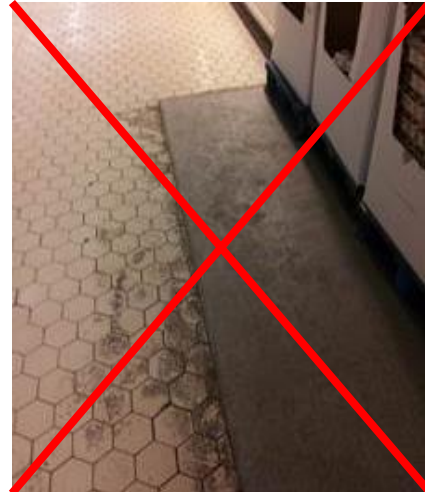
nicht geeigneter Bodenbelag
