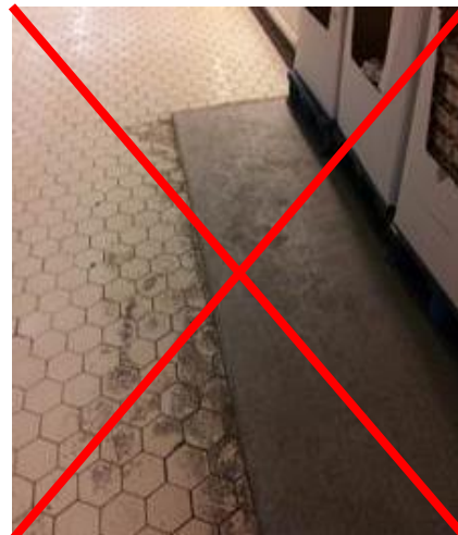
nicht geeigneter Bodenbelag
