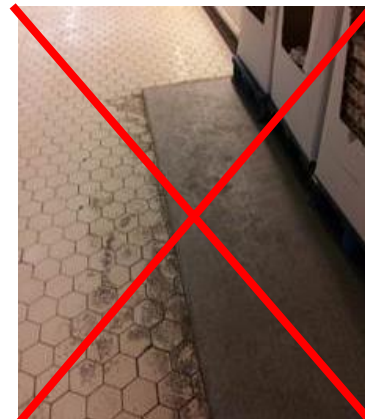
nicht geeigneter Bodenbelag
